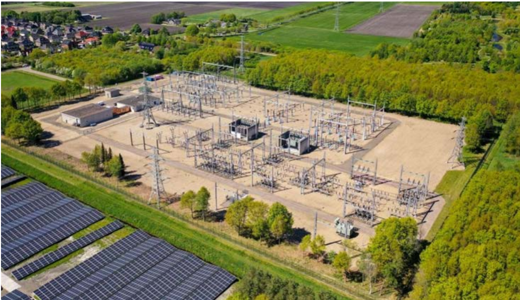
Zonnevelden in de buurt van een transformatorstation (Transformatorstation Zeijerveen Assen TenneT Holding B.V. 2020)
